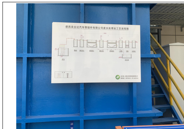
废水处理设施
