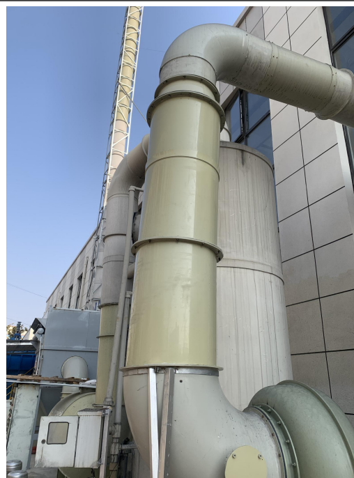
废气处理设施
