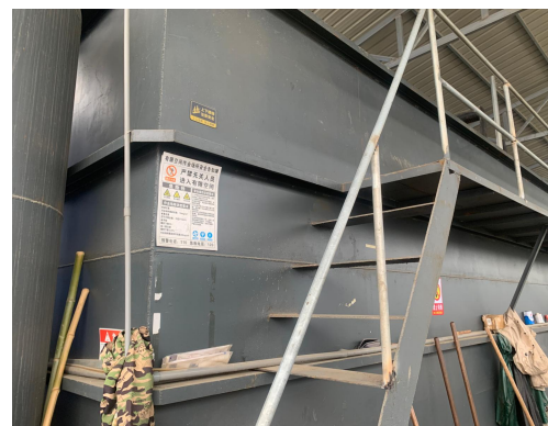
污水处理装置
