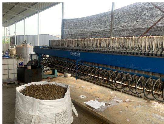
污泥压滤装置
